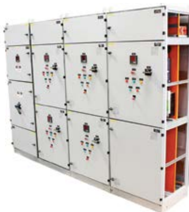
PAINEL CCM (COMPARTIMENTADO - GAVETAS) PARA ACIONAMENTO DE MOTORES
