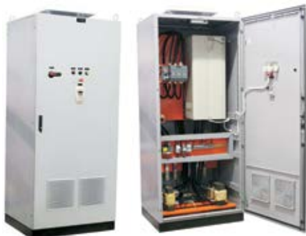
PAINEL COM INVERSOR DE FREQUÊNCIA
